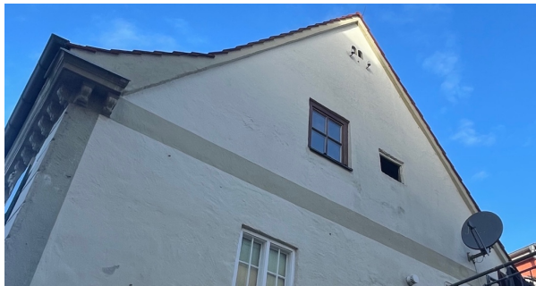
Lüftungslöcher und offenes Fenster in einem alten Haus, nahe Marktplatz
