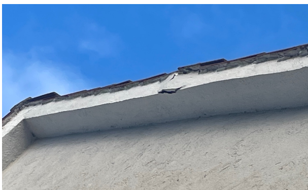
Abbildung 3: Schäden an Fassade in Dachbereich eines Hauses im Planungsgebiet
