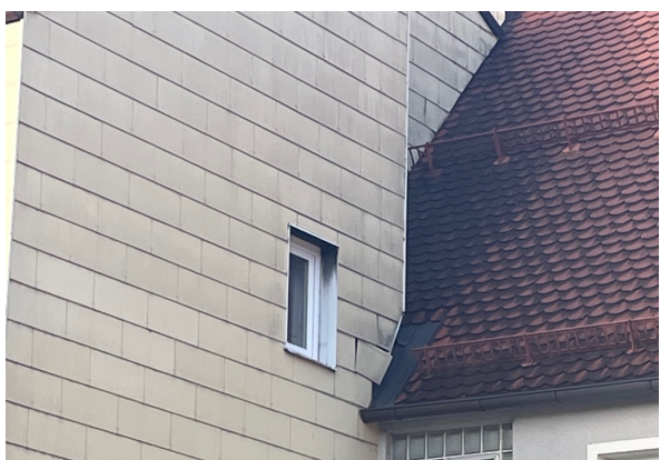
Kaputte Schindeln an einem Wohnhaus
