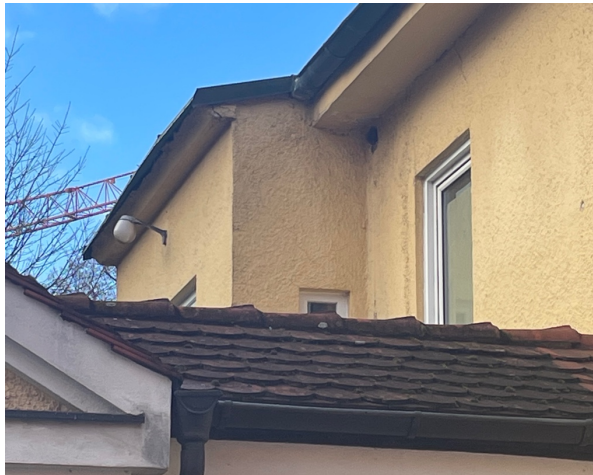
Schaden an Fassade eines Wohnhauses
