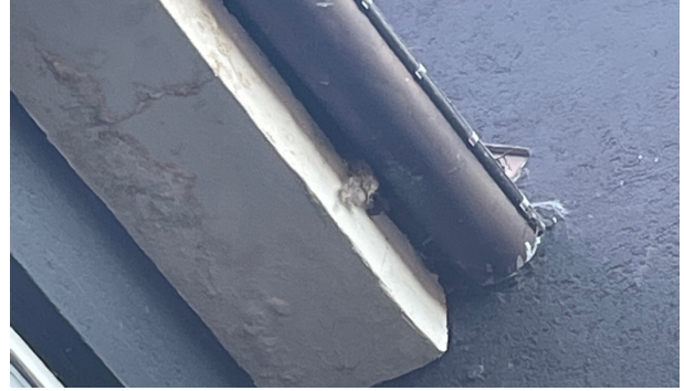
Abbildung 6: Spalte mit beschädigter Isolation unter Regenrinne eines Wohnhauses im Planungsgebiet
